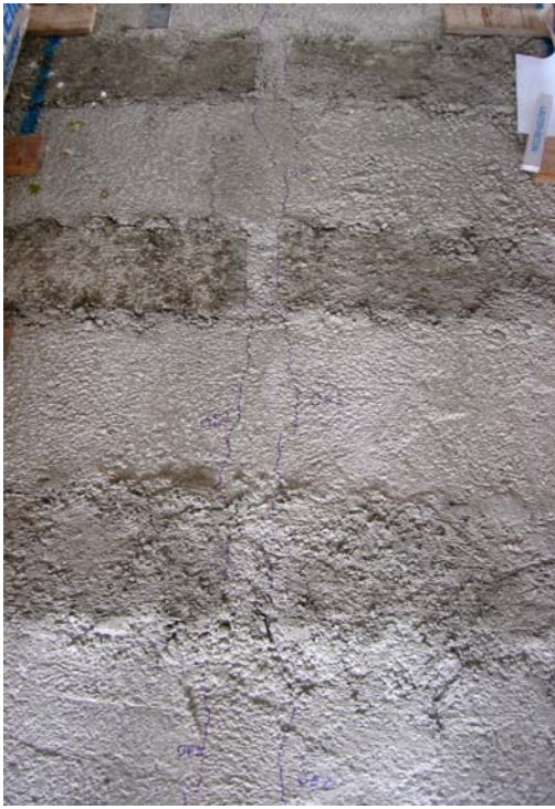
Bild 2.13: Risse bei ca. 65 % der Gebrauchslast
