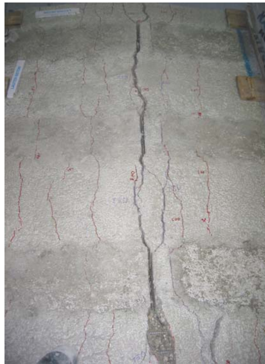
Bild 2.14: Risse bei der Bruchlast
