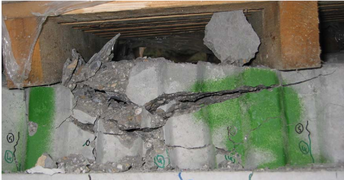
Bild 8.23: Versagen der Druckzone bei den hochfesten Stegverbundplatten
